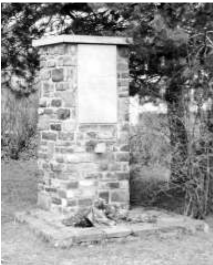
Aus WIDER DAS VERGESSEN 1999. Das Mahnmal ist noch immer stark sanierungsbedürftig
